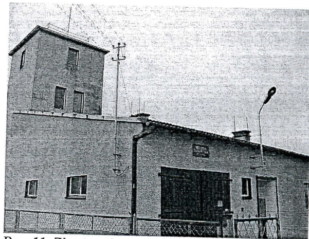
Ryc. 11. Zły stan elewacji na zewnątrz budynku.
